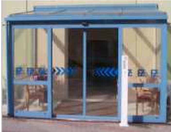
Sensor oberhalb des Durchgangs
